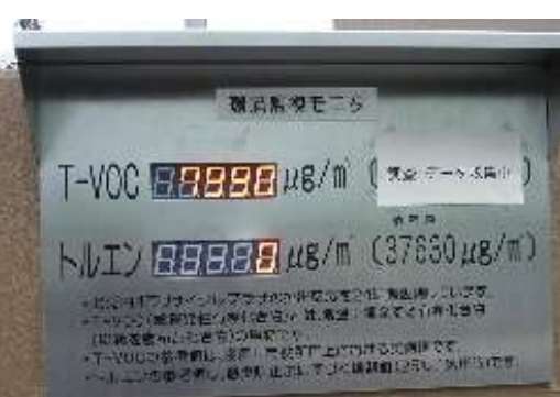
4市廃プラ処理施設の監視モニター
