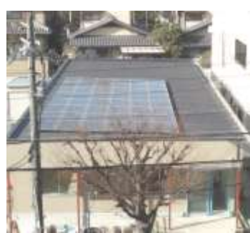
屋根に設置された太陽光パネル(市役所別館の増築庁舎)
