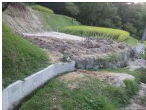
④寺地区の農地法面崩落
