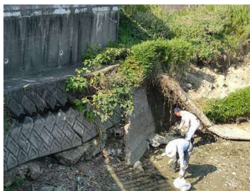
⑤星田大池の護岸崩落
