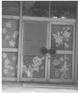
あまだのみや子ども園（ガラス破損、復旧済み）
